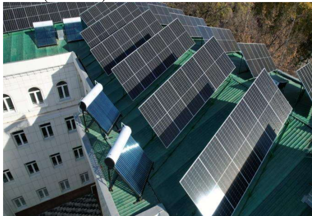
1b-rasm. Binoga o'rnatilgan quvvati 200 kVt/s bo'lgan quyosh elektr stansiyasi.
